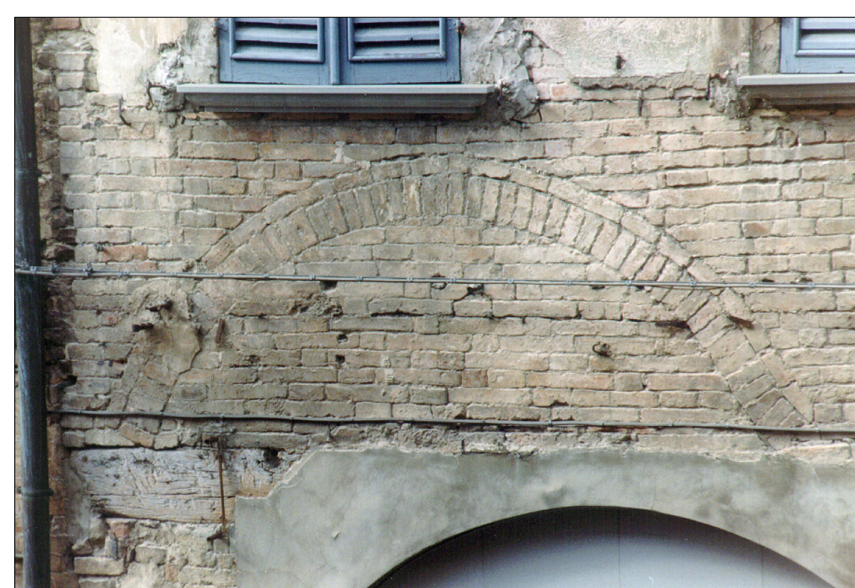
ATTRAVERSO IL DISTACCO DELL'INTONACO ORIGINARIO APPAIONO ELEMENTI STRUTTURALI ( ARCHI IN MURATURA O TRAVI LIGNEE ) CHE CONCORRONO ALL'ORGANIZZAZIONE DELLA FACCIATA. TROPPO SPESSE SONO ERRONEAMENTE INTESI COME ELEMENTI DECORATIVI DA PORRE "A VISTA", QUALI PUNTI DI INTERESSE DELLA FACCIATA.
