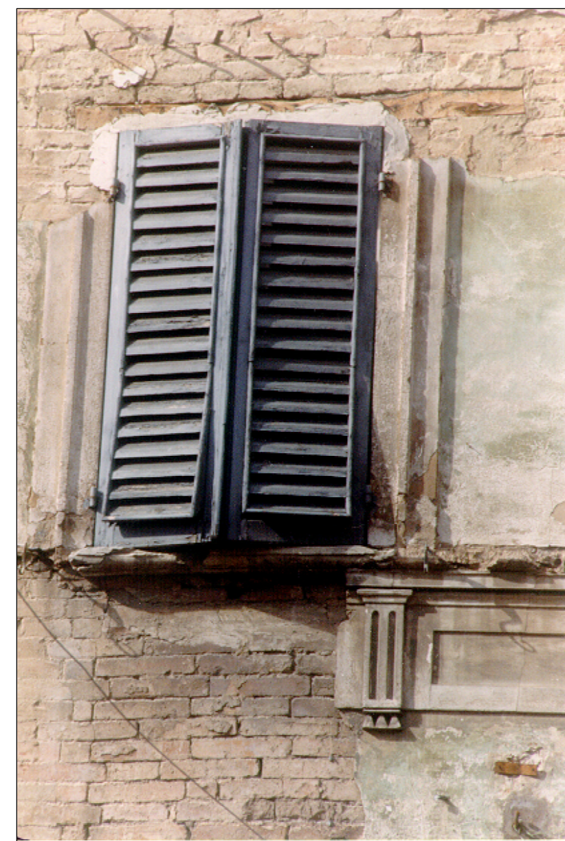
DOCUMENTAZIONE DELLA SCOMPARSA DELLA CIMASA AD ARCO E DELLA FASCIA A PANNELLI DEL SOTTODAVANZALE.
