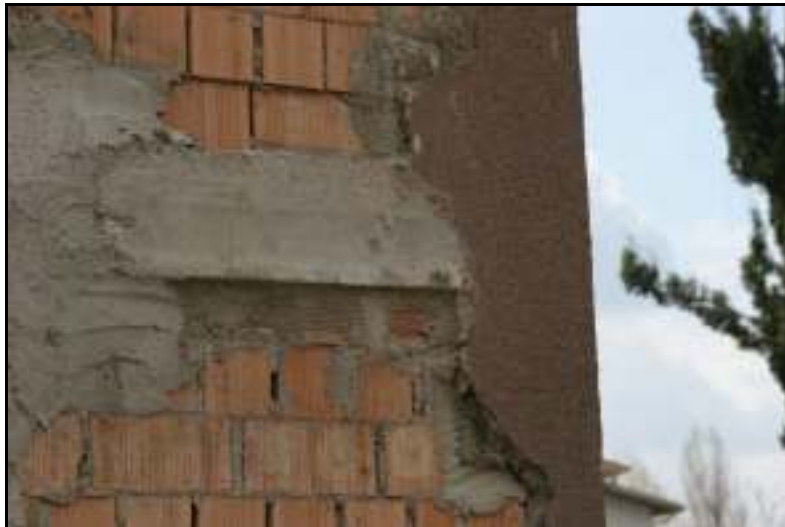
Ponte termico dovuto a trave non protetta termicamente
