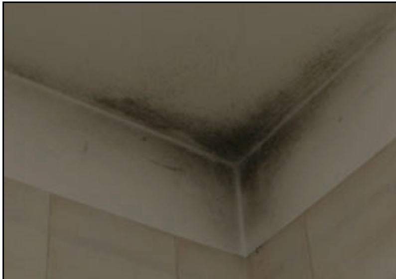
La comparsa di muffa: tipica conseguenza di un ponte termico
