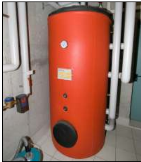
Accumulo termico per acqua calda sanitaria ed integrazione all'impianto di riscaldamento
