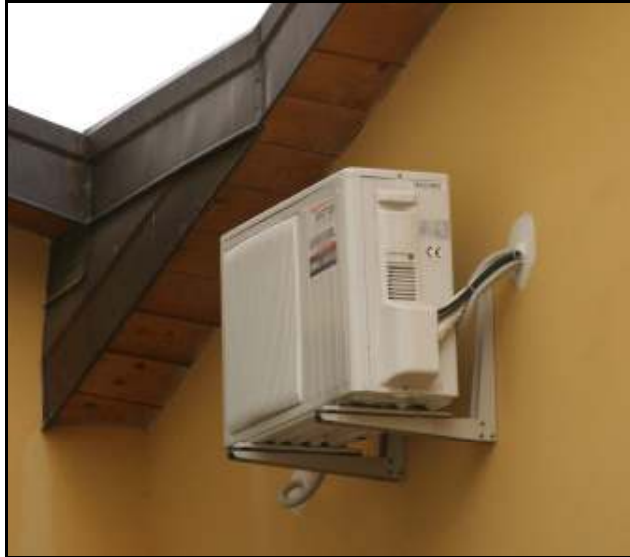
Dalla stuccatura si può notare che il climatizzatore è stato installato SUCCESSIVAMENTE al recente intervento di ristrutturazione
